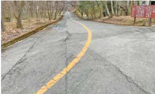
<補修工事前 : 令和7年3月12日>
